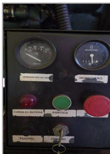
Imagem 02 – Painel com horímetro travado, que será substituído
