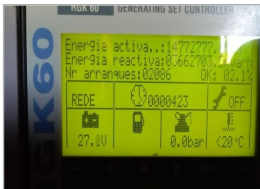
Imagem 03 – Painel controlador do sistema gerador
